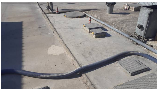
Figura 2.17– Chiusini del sistema di separazione e disoleazione delle acque meteoriche
