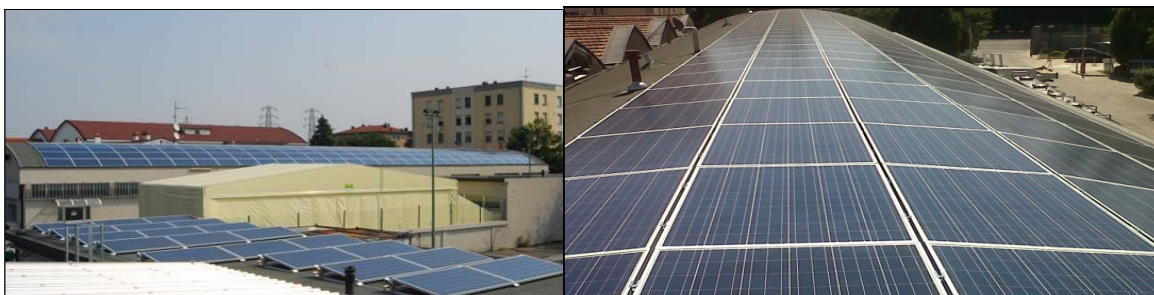
Figura 8.5 – Porzioni della copertura fotovoltaica
