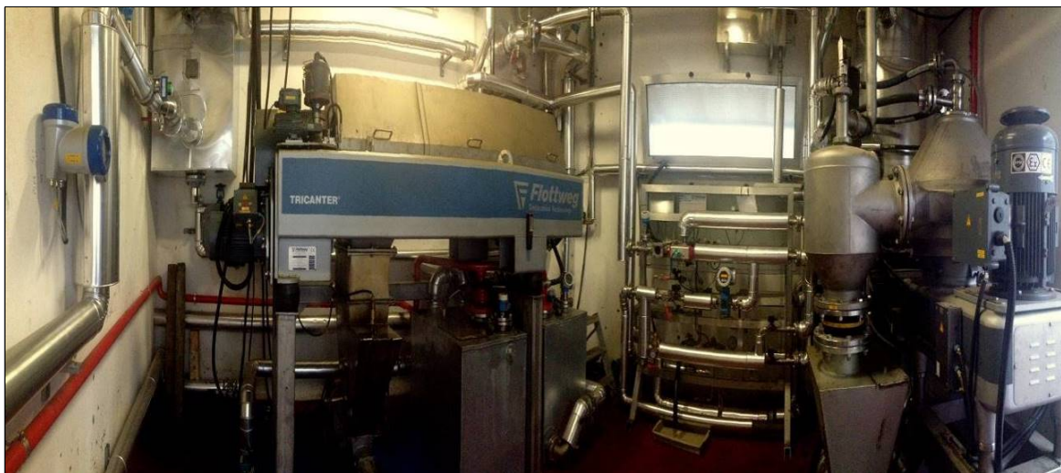
Figura 2.4– Impianto trattamento emulsioni (a sinistra il TRICANTER, a destra la CENTRIFUGA VERTICALE)
