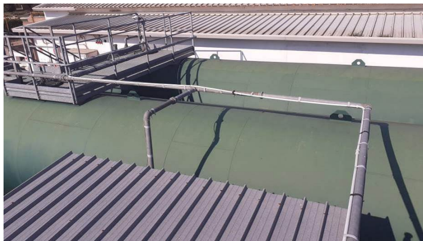
Figura 2.15– i serbatoi n. 2 e 3 visti dall'alto
